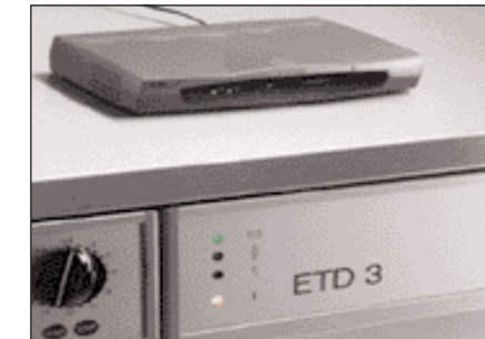
RDG-E mit ISDN-Router zum Einsatz mit Fernwartung.
