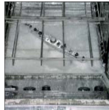
Abbildung 1 zeigt das Resultat einer Schaumbildung im RDG. Nach der Reinigungsstufe und entnommenen Siebschalen füllt der nicht abgepumpte Schaum (hier bereits wieder zum Teil zusammengefallen) den ganzen Spülraumboden des RDGs aus.
